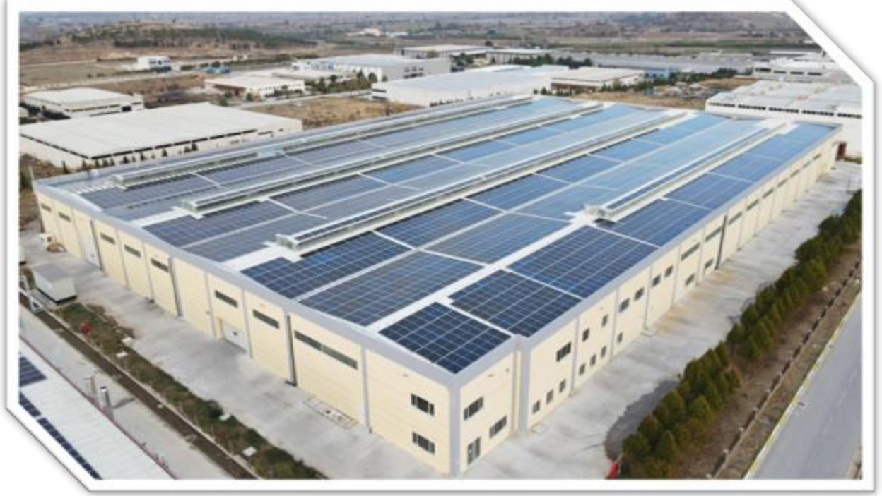
Elastomerik Kauçuk Köpük Üretim Tesisinin 14.000 m 2 Alanı Üzerine Kurulu GES
